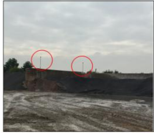
图 3-6 除尘喷淋装置
