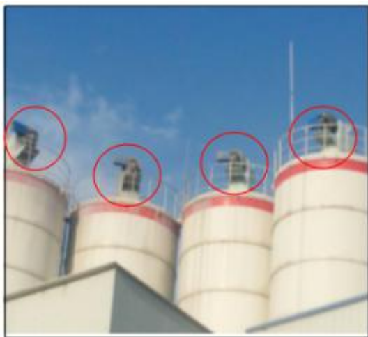
图 3-1 各储存罐顶部布袋除尘器
