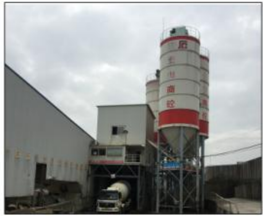
图 3-4 封闭式搅拌主楼和输送带
