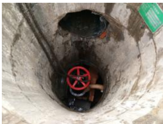
图 6-1 雨水管网总排口截流阀
