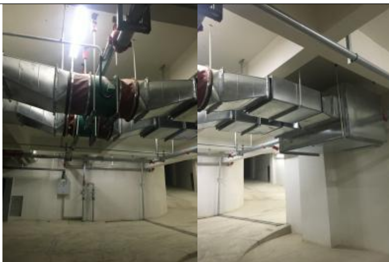
图 3-2 减震弹簧、静压箱及软管连接
