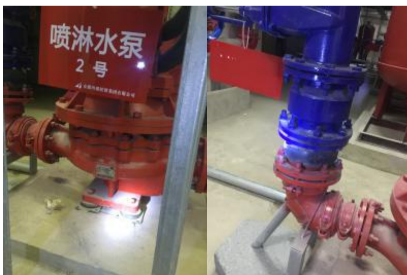
图 3-3 水泵减震基座、软管连接
