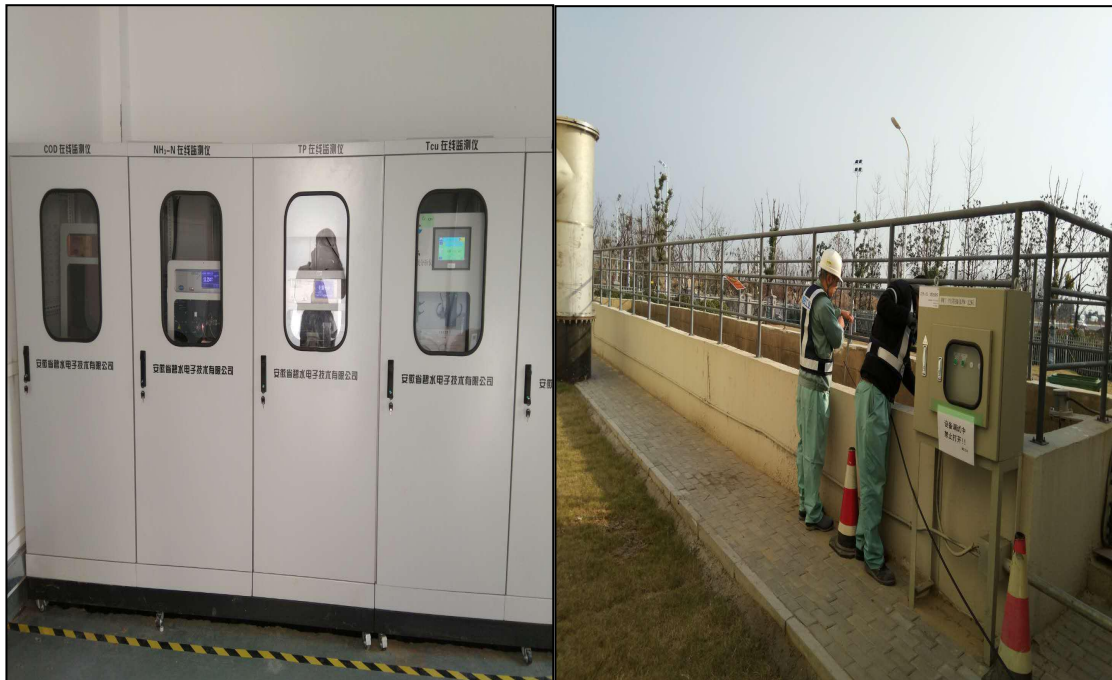
图 3-1 合肥京东方显示技术有限公司污水处理站
