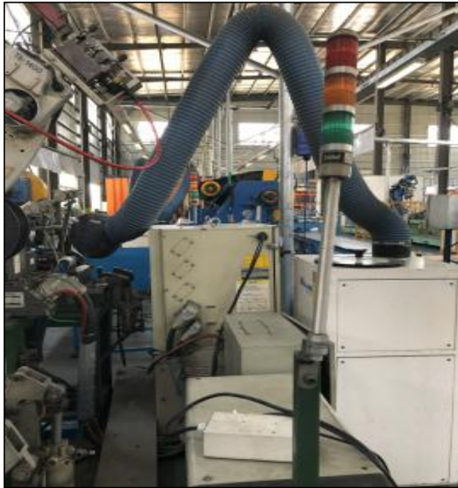
图 4.1-3 移动式焊接烟尘净化器处理设施
