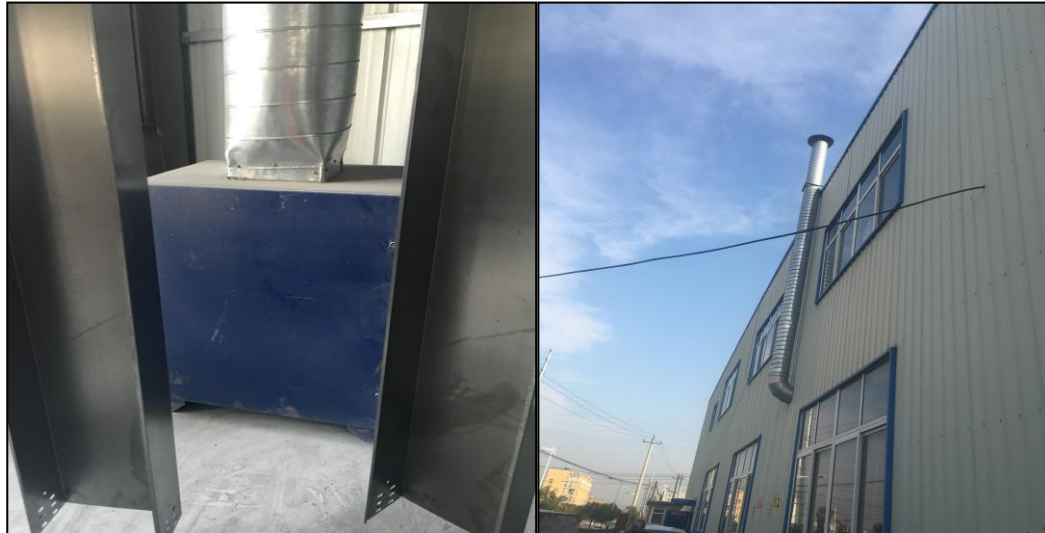
图 4.1-2 烘干固化工序非甲烷总烃治理设施
