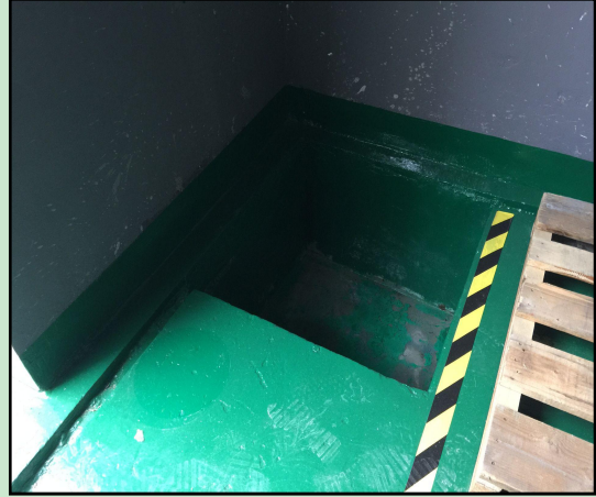
图 4.1-2 通用制冷危废库内导流槽及收集槽
