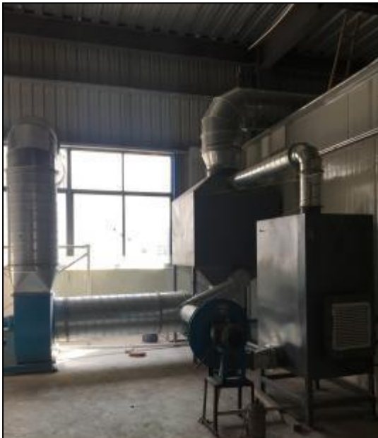
图 4.1-2 活性炭吸附+催化燃烧装置
