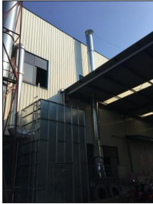
图 4.1-3 袋式除尘器+排气筒（1#）
