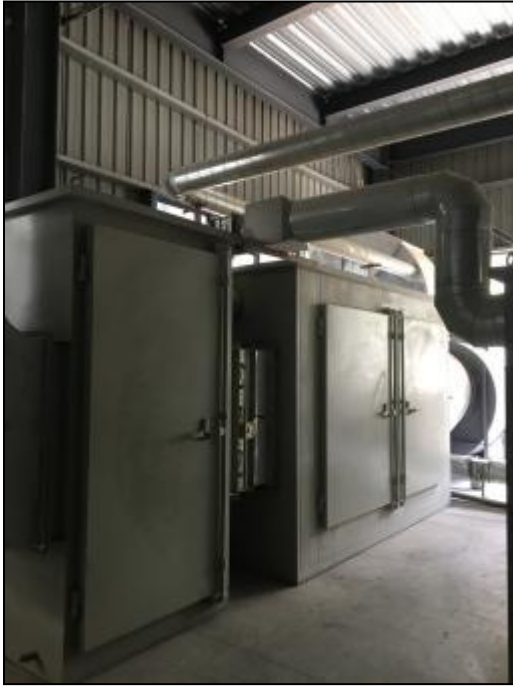
图 4.1-5 活性炭吸附+催化燃烧装置
