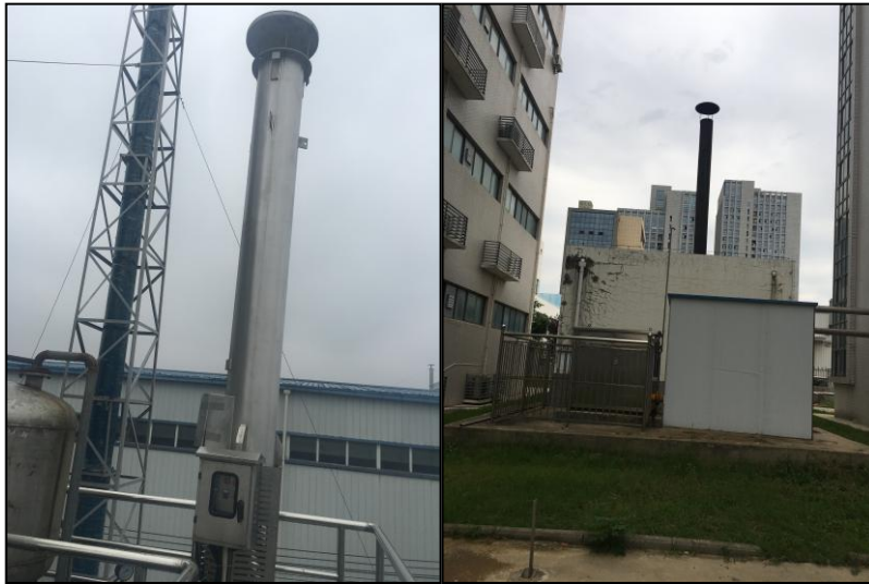
图 4.1-12 沼气燃烧器+排气筒
