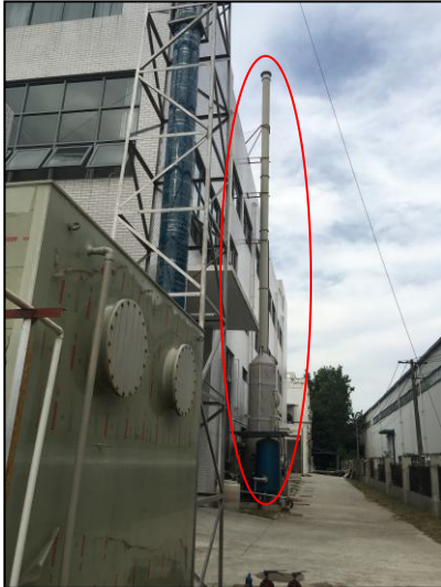
图 4.1-8 1#水洗塔+排气筒
