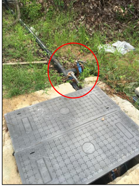
图 4.2-2 事故应急池切换阀及管道
