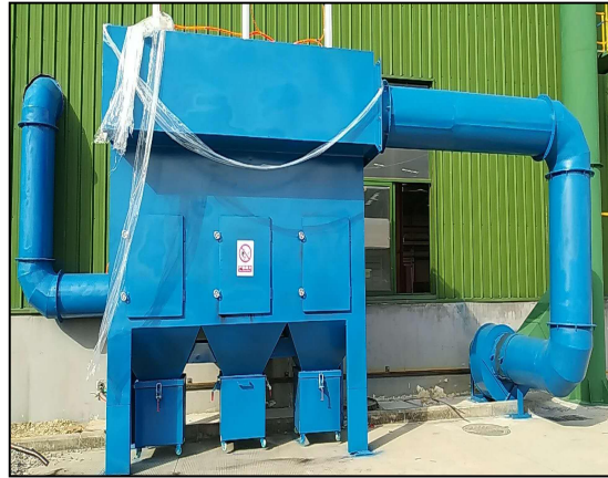
图 4.1-9 3#厂房旋风布袋除尘器
