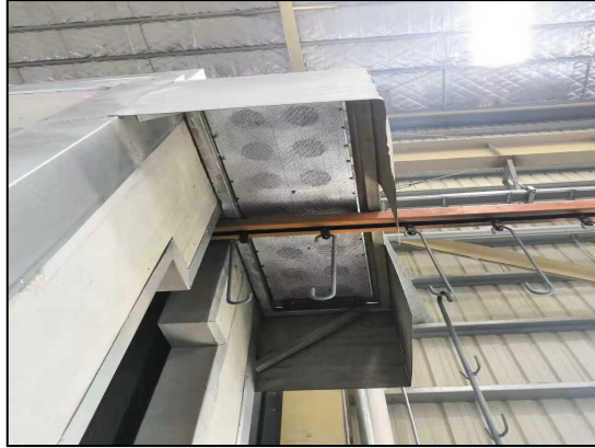
图 4.1-11 冷却器+活性炭净化装置
