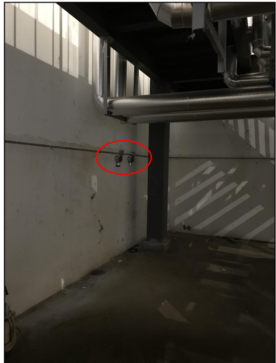
图 4.2-10 东北侧墙面氨气浓度监控探头
