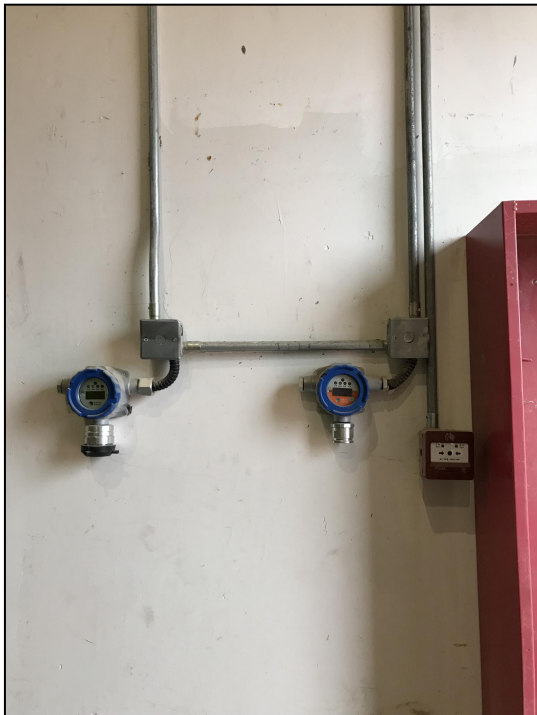
图 4.2-9 南侧墙面氨气浓度监控探头
