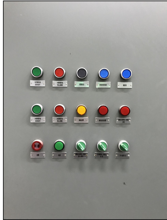
图 4.2-12 防爆风机及监控报警控制柜
