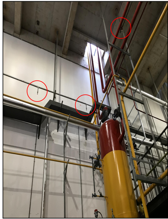
图 4.2-3 水喷淋装置及氨气浓度监控探头
