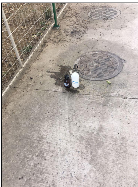
图 4.1-1 污水排口图片
