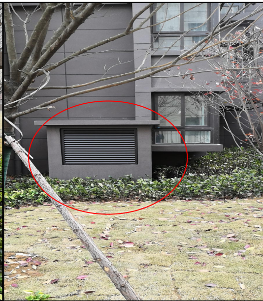
图 4.1-4 地下停车场排风口
