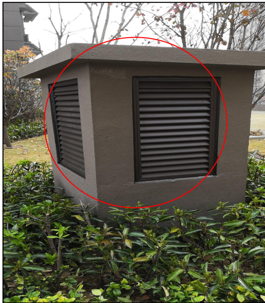
图 4.1-3 地下停车场排风口
