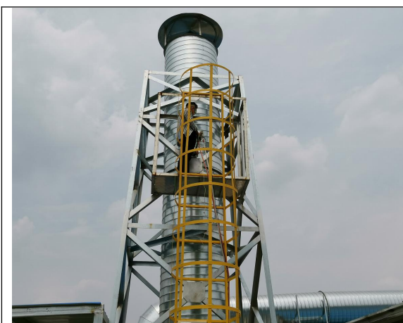
图 1 排气筒 P2 出口
