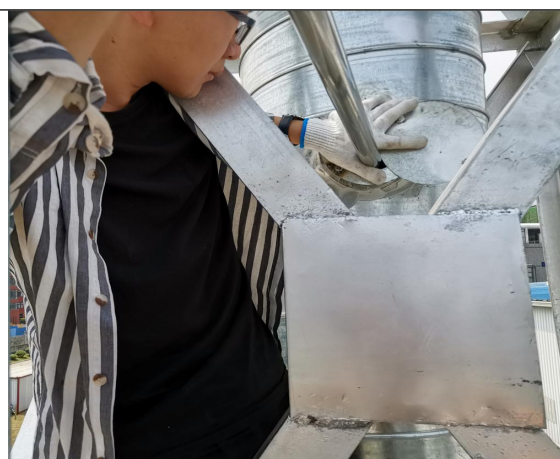
图 2 排气筒 P1 出口
