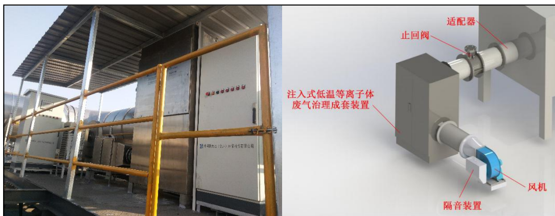
图 4.1-6 注塑废气注入式低温等离子体废气治理装置
