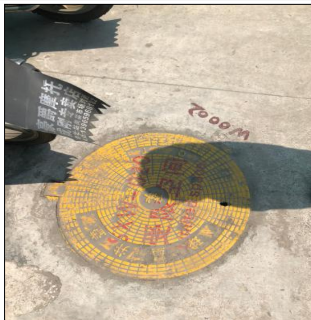
图 4.1-1 厂内污水总排口
