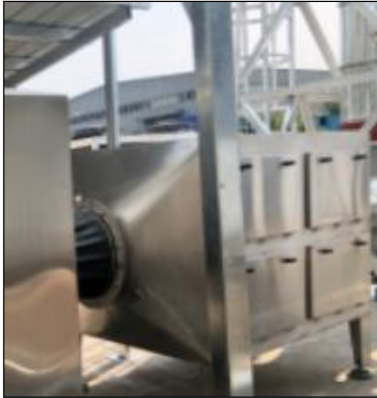
图 4.1-8 注塑工艺活性炭吸附装置
