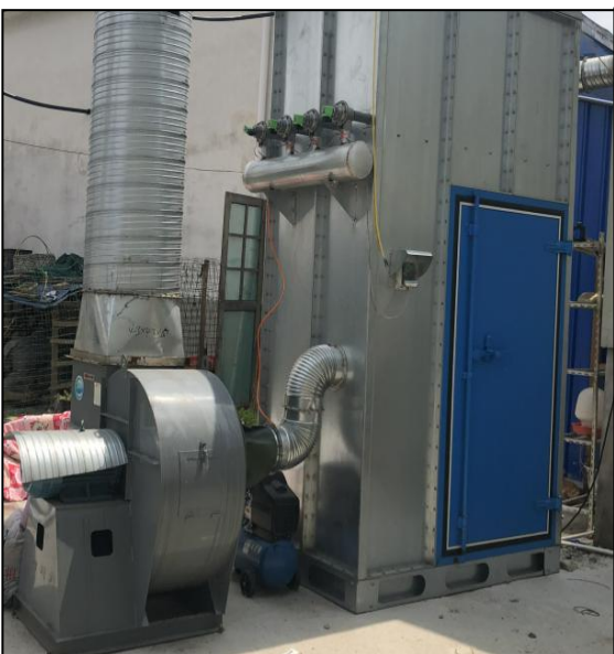
图 4.1-5 破碎工序布袋除尘器
