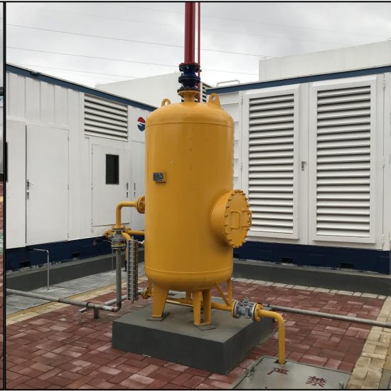
图 4.1-2 撬装集成 CNG 供气系统缓冲罐
