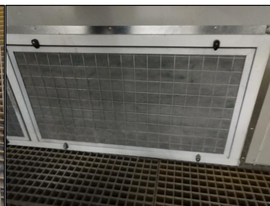
图 4.1-11 打磨房正北方向墙体壁面滤棉层
