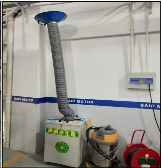
图 4.1-15 移动式焊接烟尘净化器
