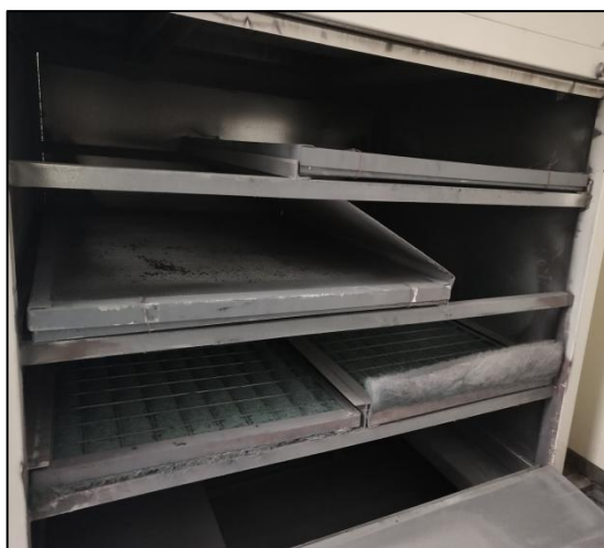
图 4.1-8 活性炭吸附装置内部活性炭过滤棉
