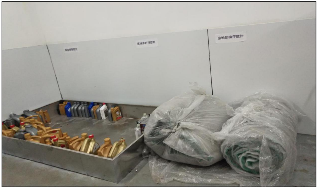
图 4.1-16 危废库内防泄漏托盘、四周墙体防渗面板、危废分区摆放
