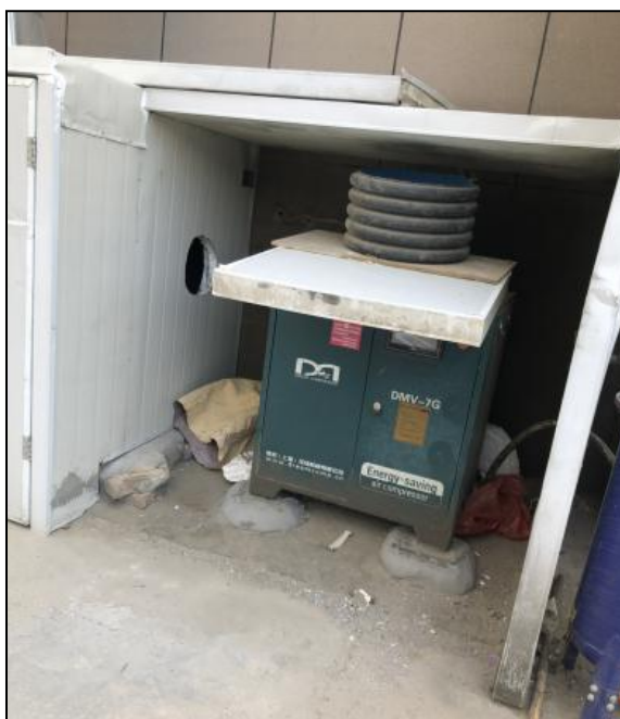
图 4.1-12 厂区西侧单独的空压机房
