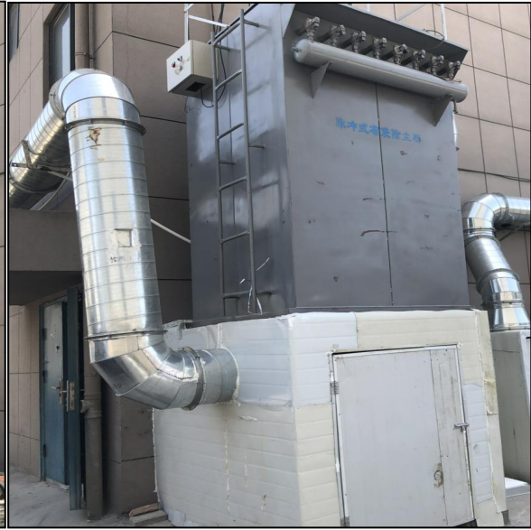
图 4.1-6 磨边工序新建的布袋除尘器 (2#)
