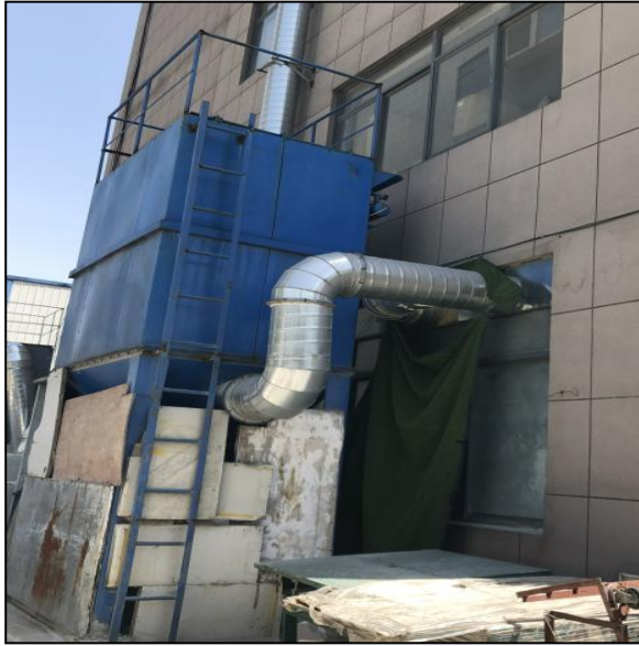
图 4.1-5 混料工序现有布袋除尘器 (1#)
