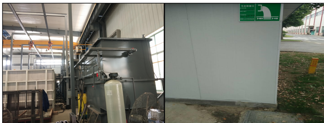
图 4.1-2 污水处理站照片
