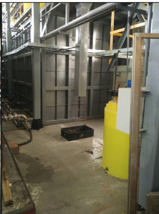
图 4.1-14 污水处理站照片
