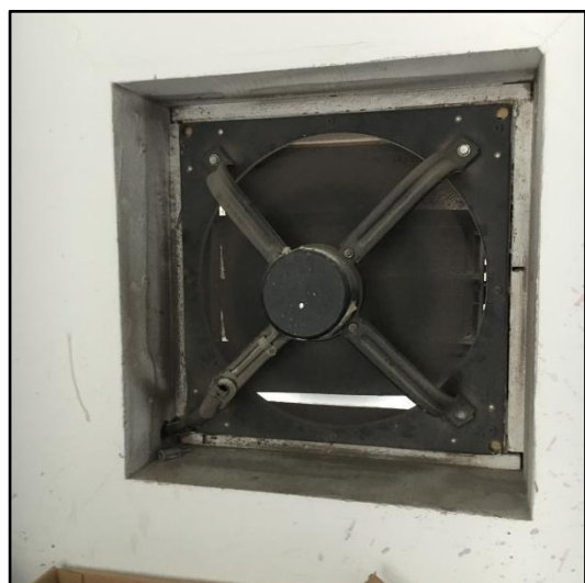
图 4.2-3 储漆室排风扇
