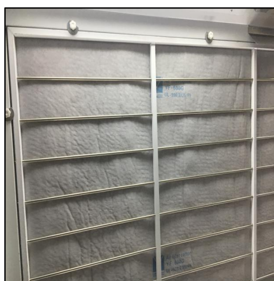
图 4.1-7 喷烤漆房侧面过滤棉
