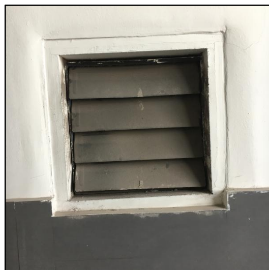
图 4.2-3 储漆室排风扇
