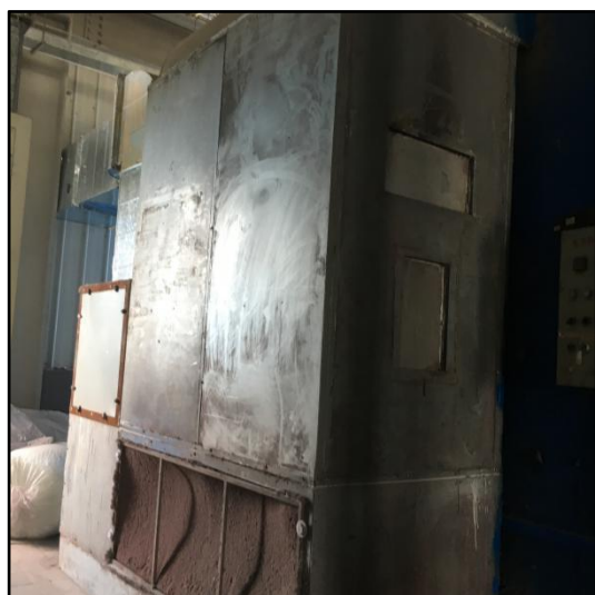
图 4.1-4 2#喷烤漆房废气处理设施
