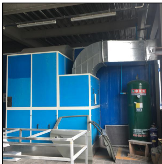
图 4.1-3 1#喷烤漆房废气处理设备
