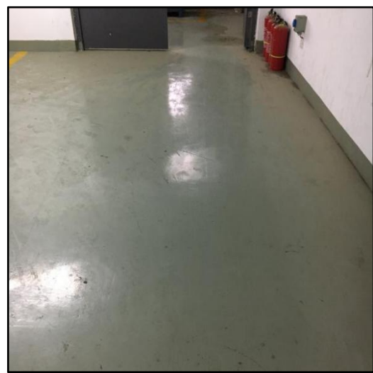
图 4.1-20 危废暂存间内部防腐防渗
