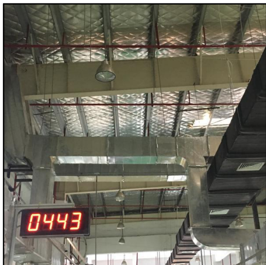
图 4.1-3 废气收集总管道
