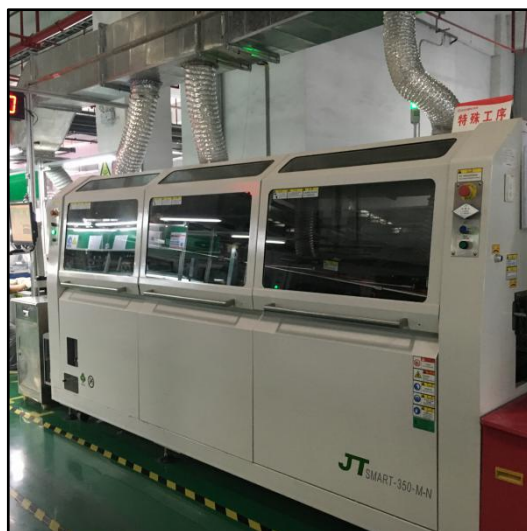
图 4.1-4 波峰焊废气收集管道
