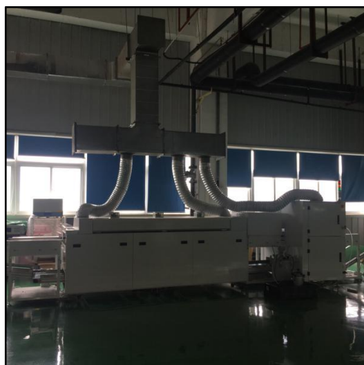
图 4.1-6 三防胶涂覆废气收集管道
