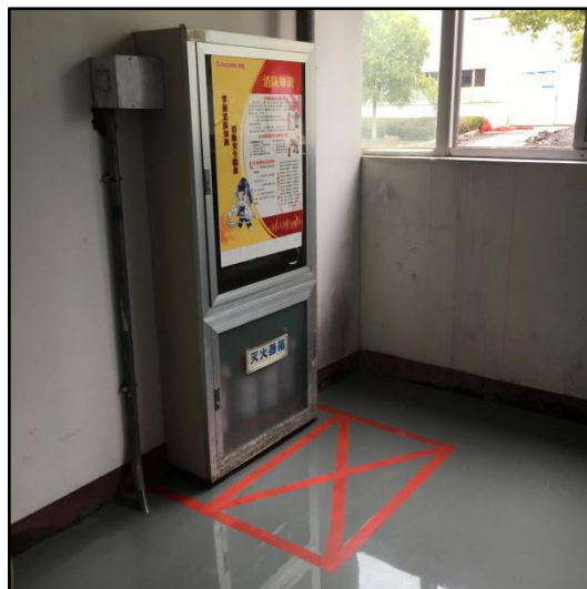
图 4.1-20 危废暂存间消防用品暂存区
