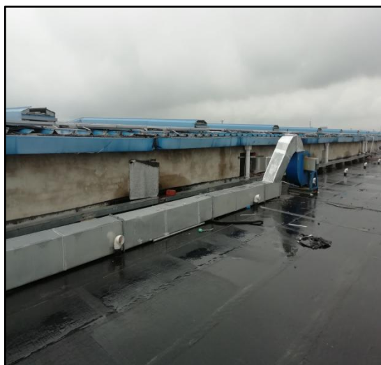
图 4.1-11 三防漆废气管道
