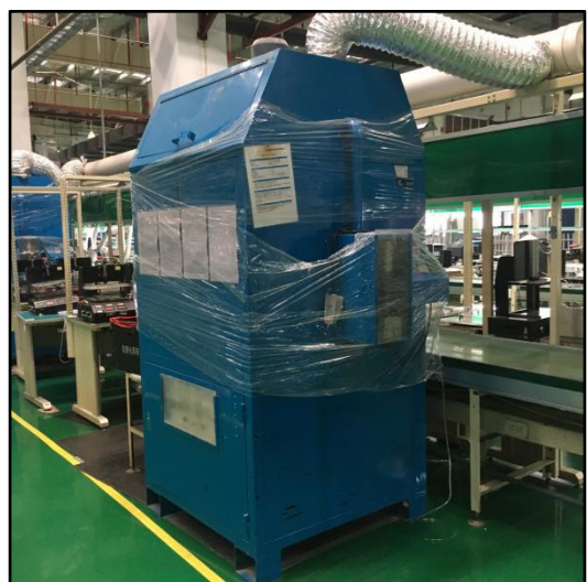
图 4.1-5 灌胶废气收集管道
