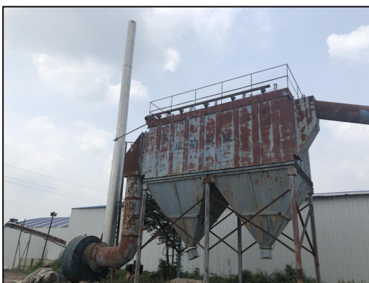
图 4.1-13 布袋除尘器+排气筒
