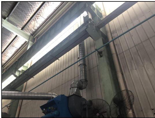
图 4.1-5 焊接工位排气筒
