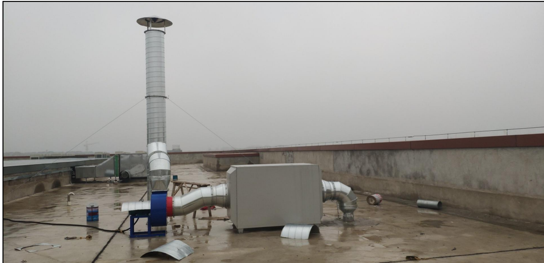
图 4.1-5 排气筒及设备照片
