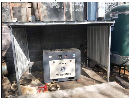
图 4.1-1 空压机房照片
