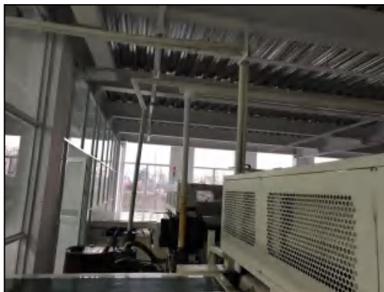
图 4.1-7 层压机管道照片
