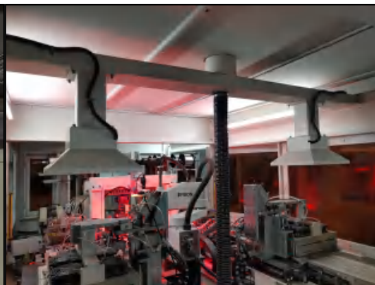
图 4.1-8 串焊机自带集气罩及管道照片
