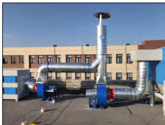
图 4.1-5 排气筒及风机照片
