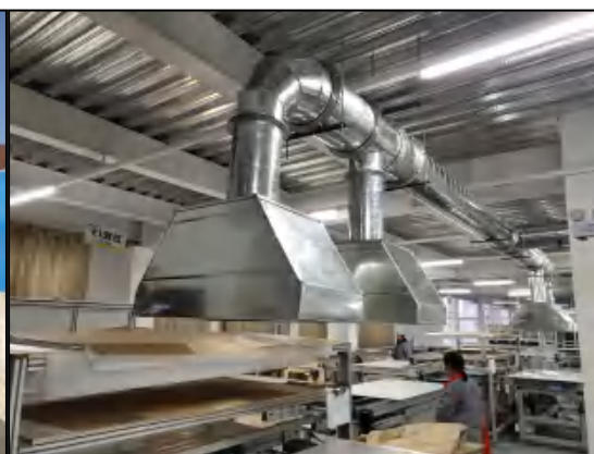
图 4.1-6 点焊工位集气罩照片
