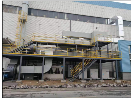
图 4.1-8 干式过滤+活性炭吸附装置
