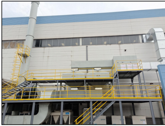
图 4.1-7 干式过滤+活性炭吸附装置
