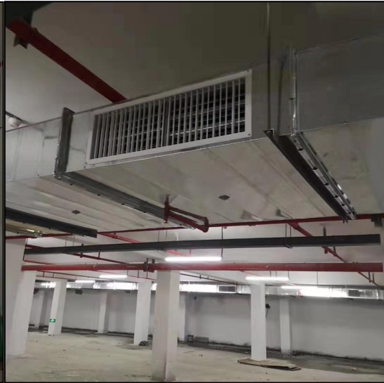
图 4.1-6 地下车库风机
