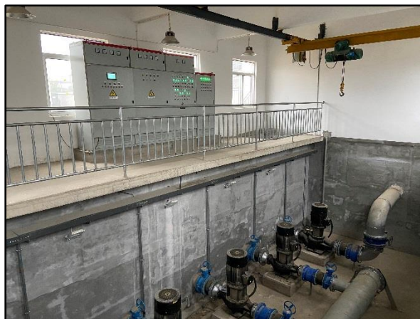
图 4.1-7 二级泵房水泵
