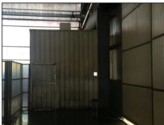
图 4.1-6 空压机房照片
