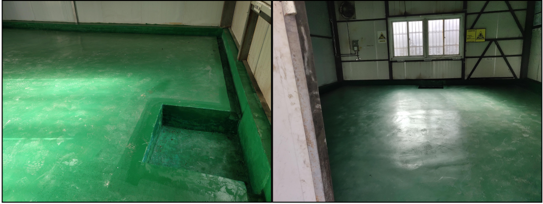
图 4.2-1 油品库内部照片
