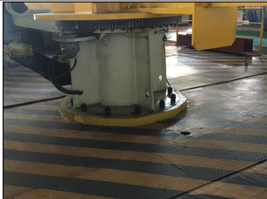
图 4.1-11 设备固定螺栓照片
