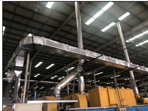
图 4.2-17 3#厂房集气管道
