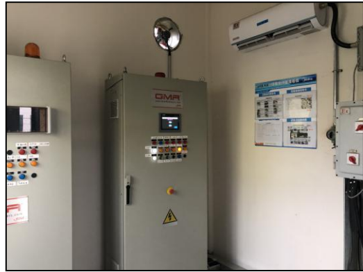
图4.2-7 环戊烷控制室报警系统
