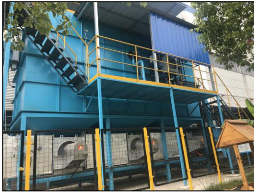
图 4.2-18 过滤+RTO 蓄热焚烧炉装置
