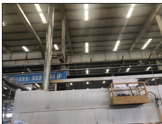
图 4.2-22 4#厂房集气管道
