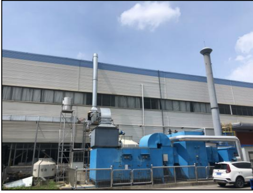
图 4.2-23 废气处理装置
