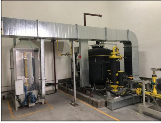
图 4.1-5 预混间集气管道
