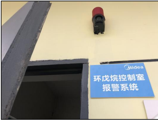
图4.2-6 环戊烷控制室
