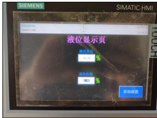
图4.2-9 储罐液位显示器
