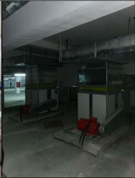
图 4.1-7 地下车库风机
