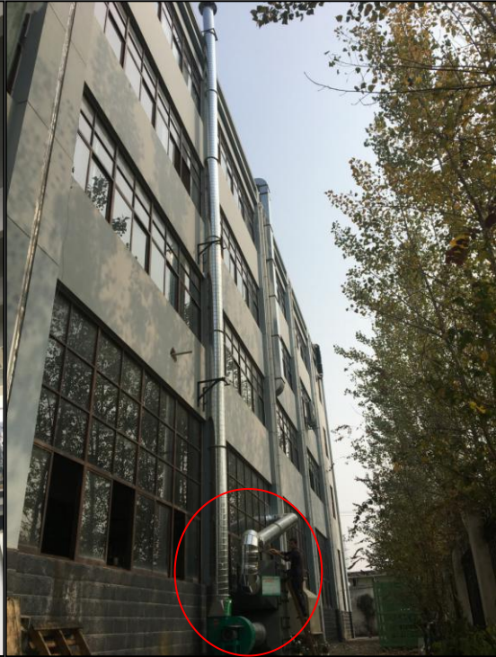
图 4.1-4 二级活性炭+排气筒
