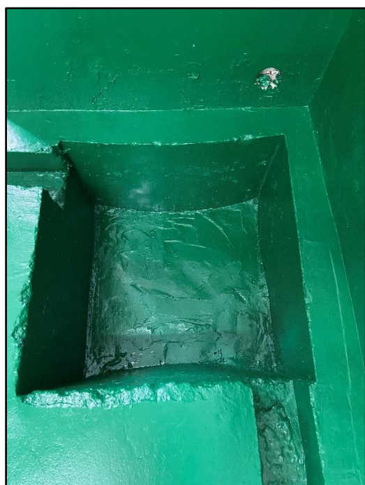
图 4.1-4 危废暂存间收集池
