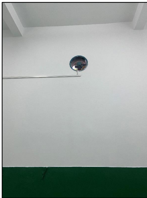
图 4.1-7 危废暂存间通风风机
