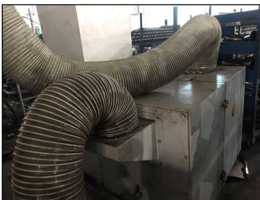
图 4.1-10 激光切割机自带处理设备
