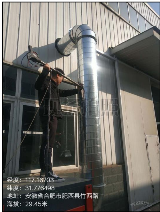
图7 排气筒 P2 进口
