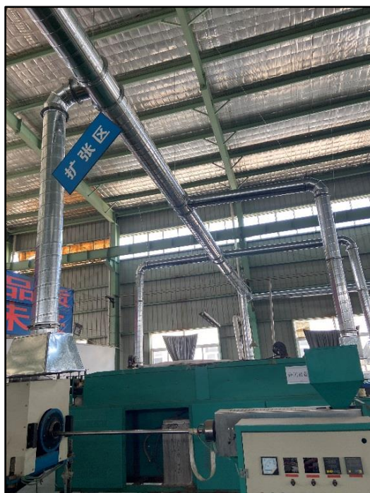
图 4.1-11 热扩区集气管道
