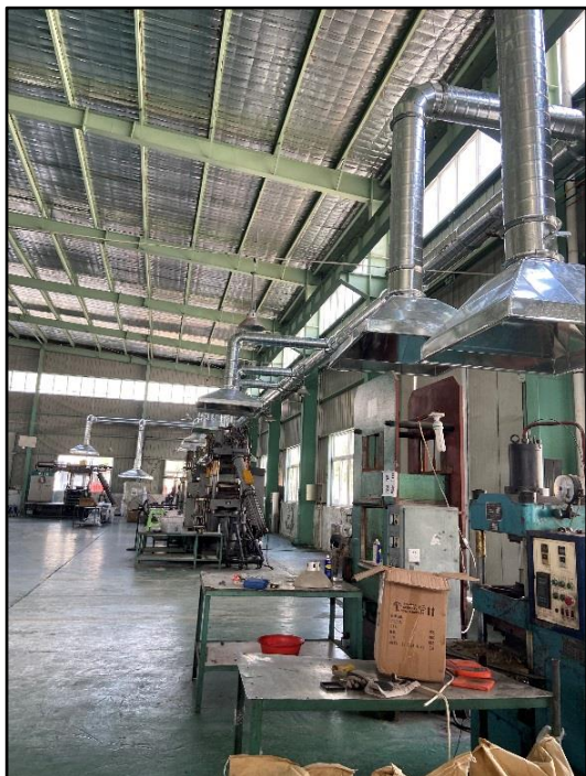
图 4.1-4 废气集气管道
