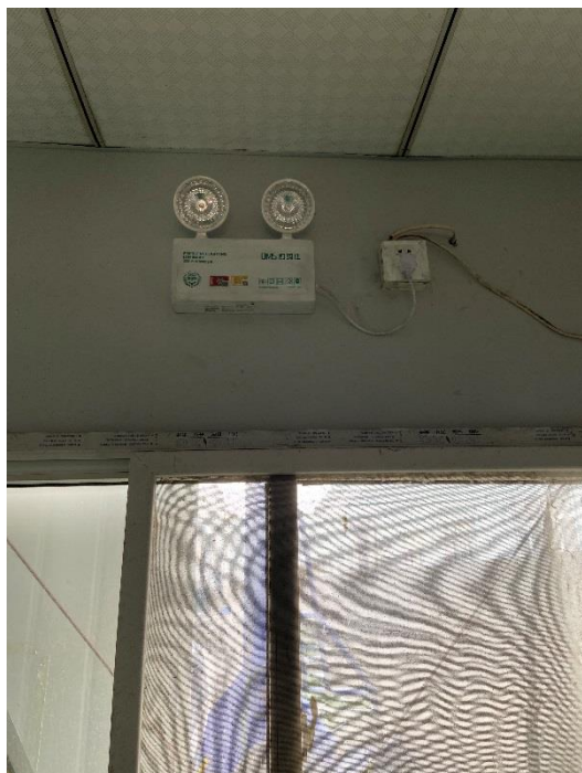
图 4.1-35 应急照明设施
