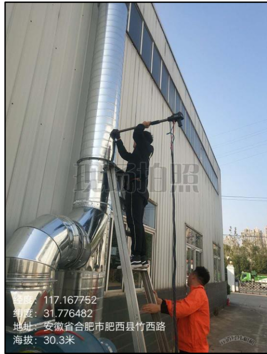
图6 排气筒 P1 出口
