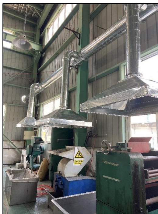
图 4.1-15 破碎机集气管道
