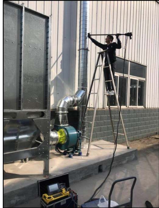
图10 排气筒 P3 出口
