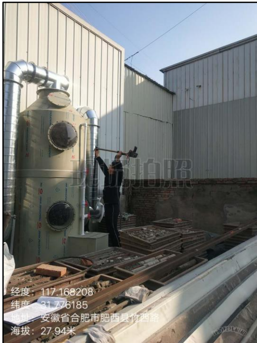
图11 排气筒 P4 进口
