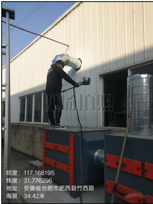
图 13 排气筒 P5 进口
