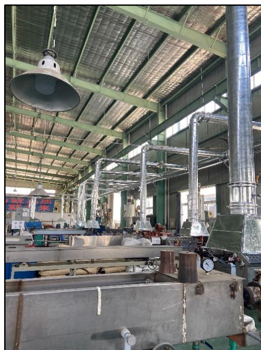
图 4.1-8 挤出废气集气管道
