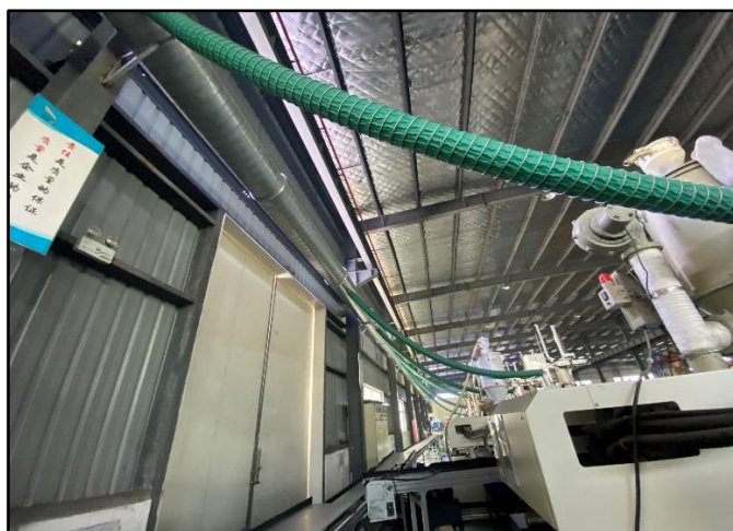
图 6.1-4 注塑废气集气管道
