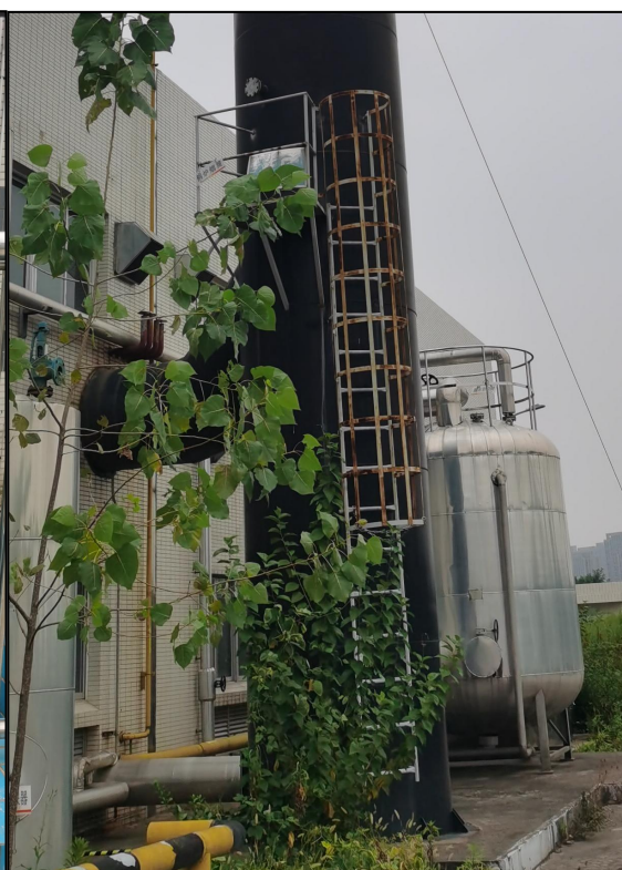
图 4.1-12 废气采样平台
