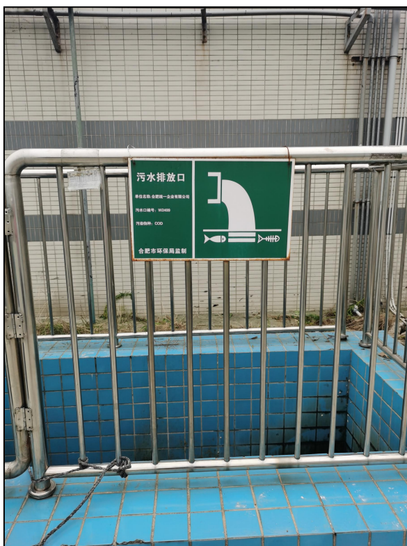
图 4.1-11 污水总排口规范化
