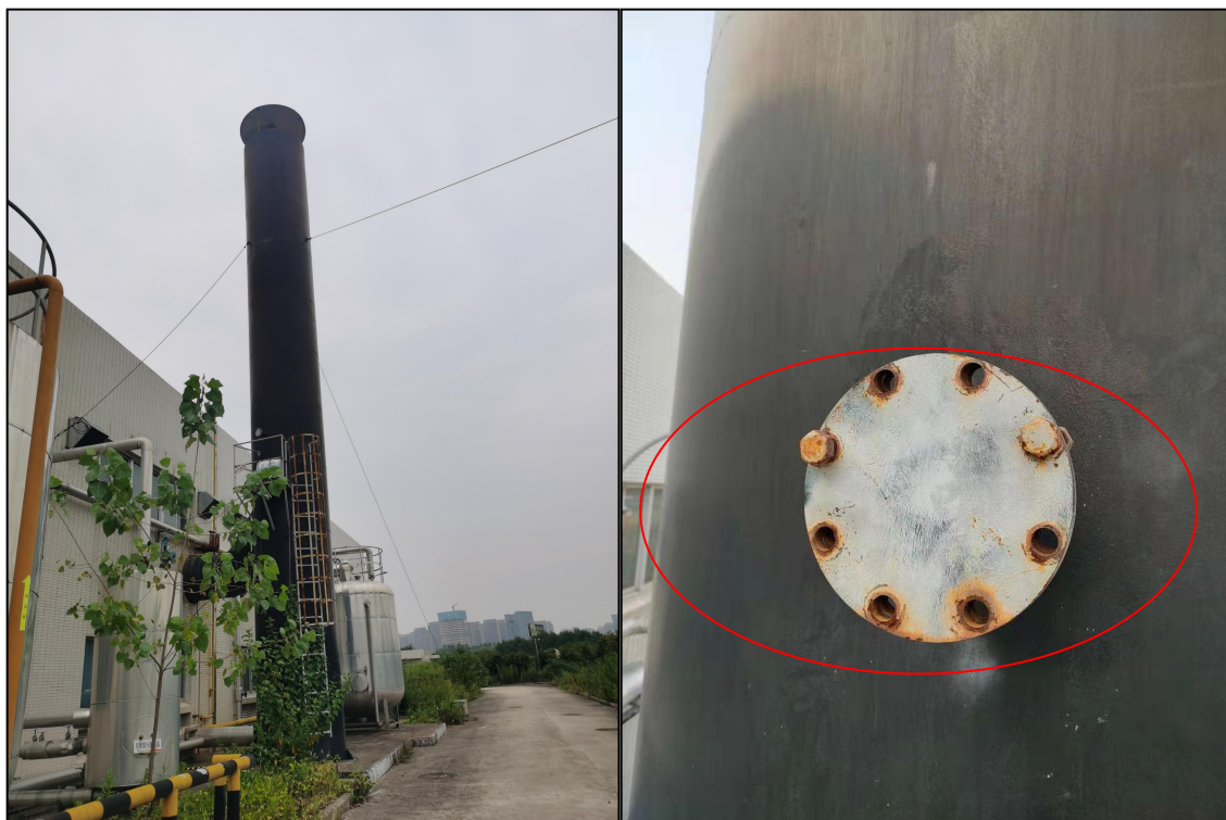
图 4.1-3 低氮燃烧器+排气筒
