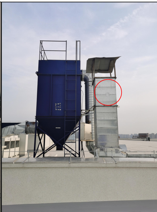
图 4.1-7 布袋除尘器+排气筒 P1
