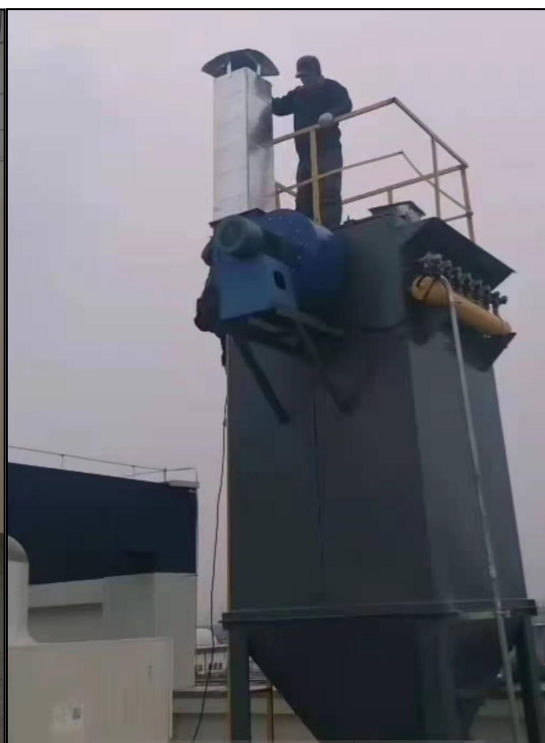
图 4.1-9 布袋除尘器+排气筒 P3
