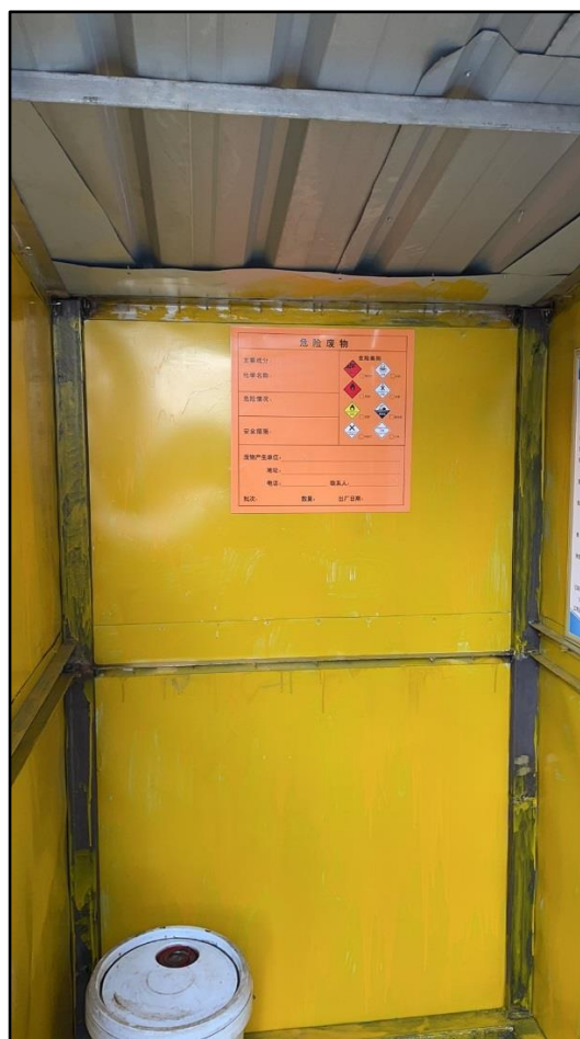
图 4.1-4 危废暂存间内部标识
