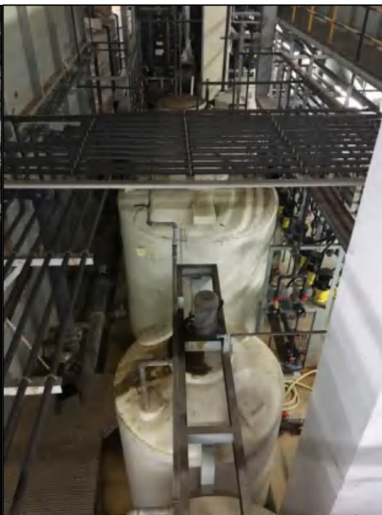
图4.1-8 重金属废水预处理装置
