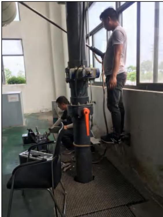
图 4.1-37 污水处理总站切断阀
