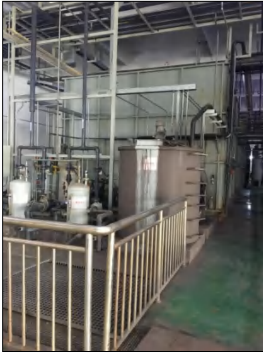
图4.1-5 酸碱废水预处理装置
