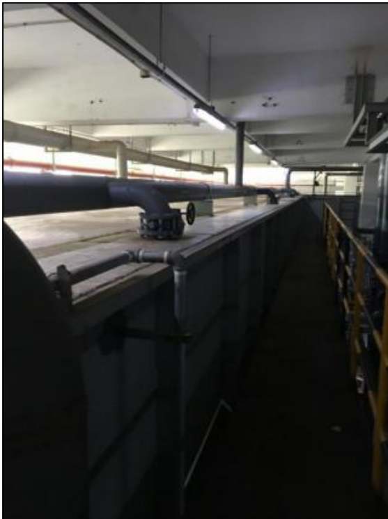
图4.1-23 接触氧化池盖板
