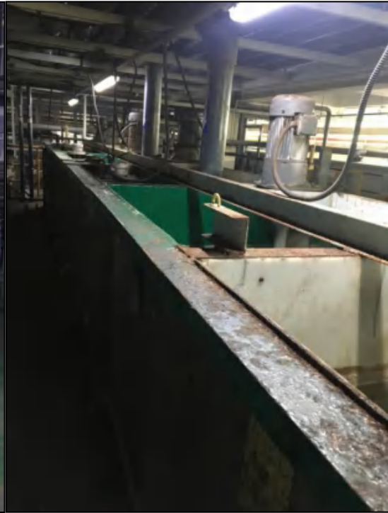
图4.1-6 重金属废水预处理装置
