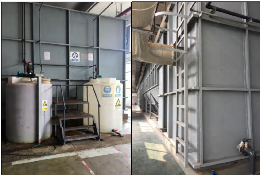
图 4.1-10 污水处理总站
