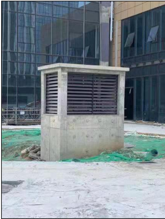
图 4.1-3 地下车库排风口
