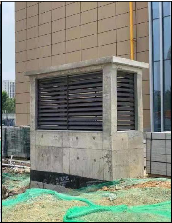
图 4.1-4 地下车库排风口
