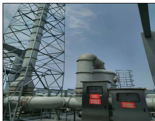
图 4.1-14 焚烧塔+喷淋塔
