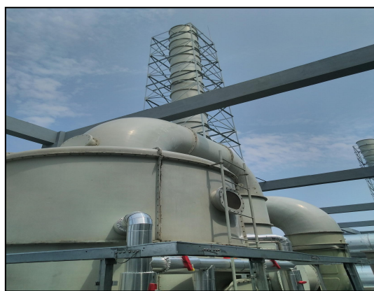
图 4.1-9 二级 NaOH 溶液筛板填料洗涤塔
