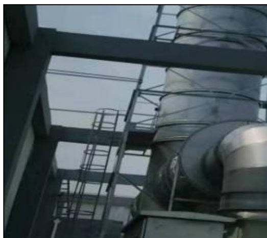
图 4.1-28 废气监测平台
