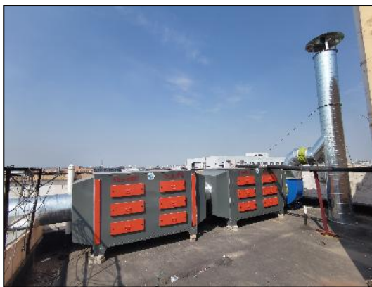
图 4.1-8 二级活性炭吸附装置+排气筒 (1#)
