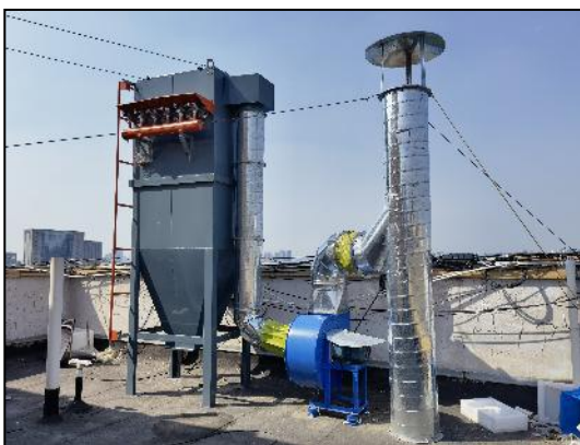
图 4.1-13 布袋除尘器+排气筒 (2#)
