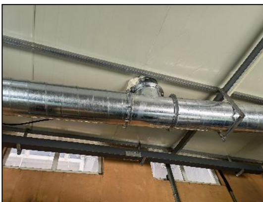
图 4.1-11 破碎粉尘集气管道
