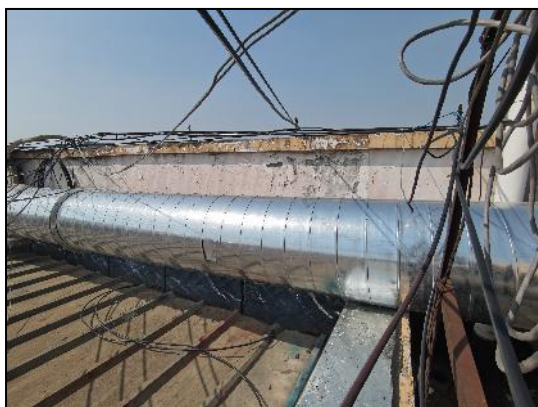
图 4.1-12 破碎粉尘集气管道
