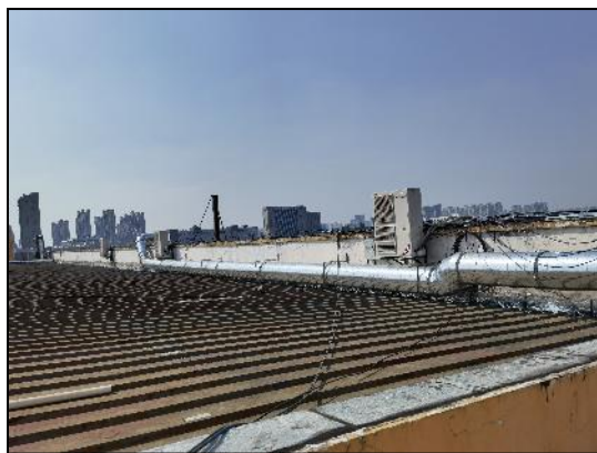
图 4.1-7 注塑废气集气管道
