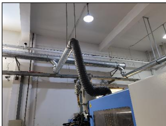
图 4.1-6 注塑废气集气管道
