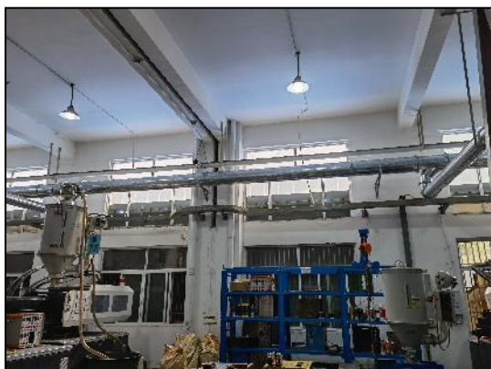
图 4.1-5 注塑废气集气管道
