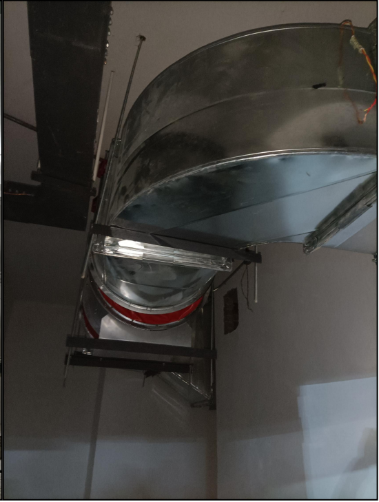
图 4.1-7 地下车库风机
