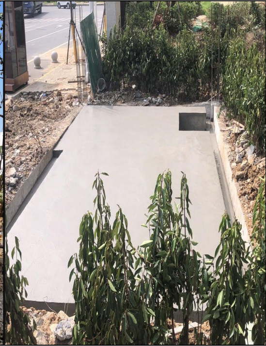
图 4.1-5 垃圾桶临时集中堆放处排水沟
