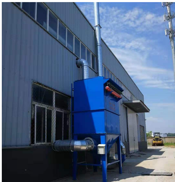
图 4.1-8 布袋除尘器及 P2 排气筒
