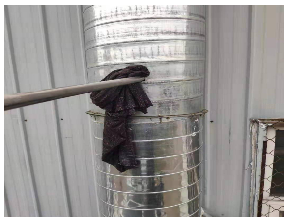
图 5-6 有组织废气监测照片 (P1 排气筒出口)
