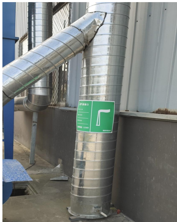
图 4.3-2 P2 排气筒标识牌
