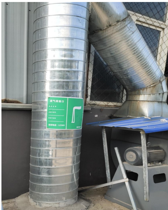
图 4.3-1 P1 排气筒标识牌
