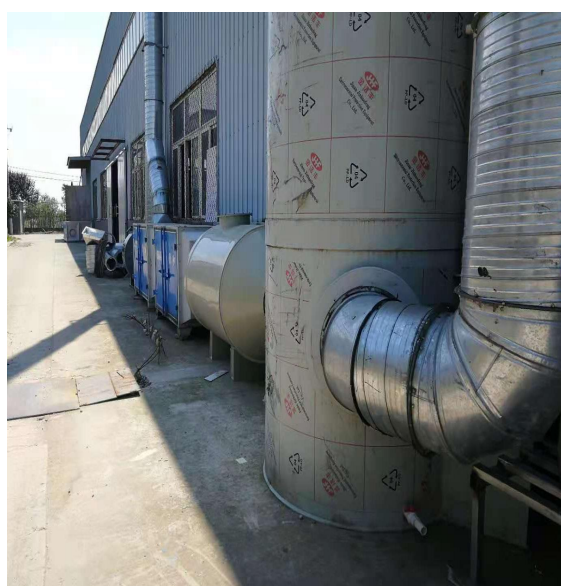
图 4.1-6 碱喷淋+二级活性炭吸附装置
