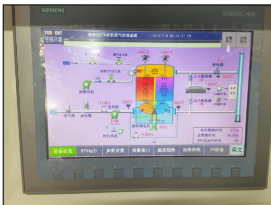
图 4.1-13 RTO 治理系统
