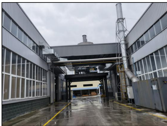
图 4.1-9 蓄热式氧化炉 RTO 装置位置
