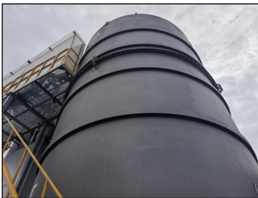
图 4.1-10 蓄热式氧化炉 RTO 装置
