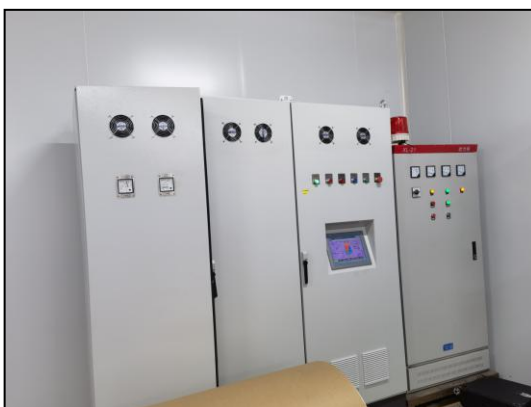
图 4.1-12 RTO 治理系统
