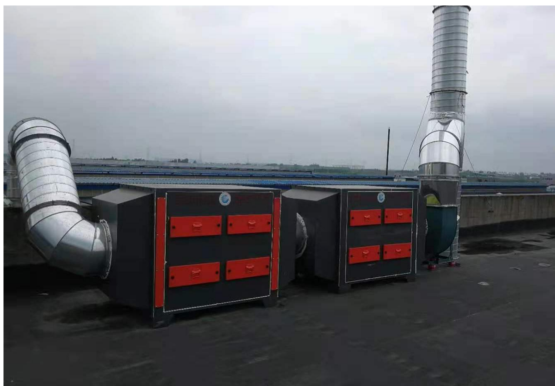
图 4.1-6 二级活性炭吸附装置及 P1 排气筒
