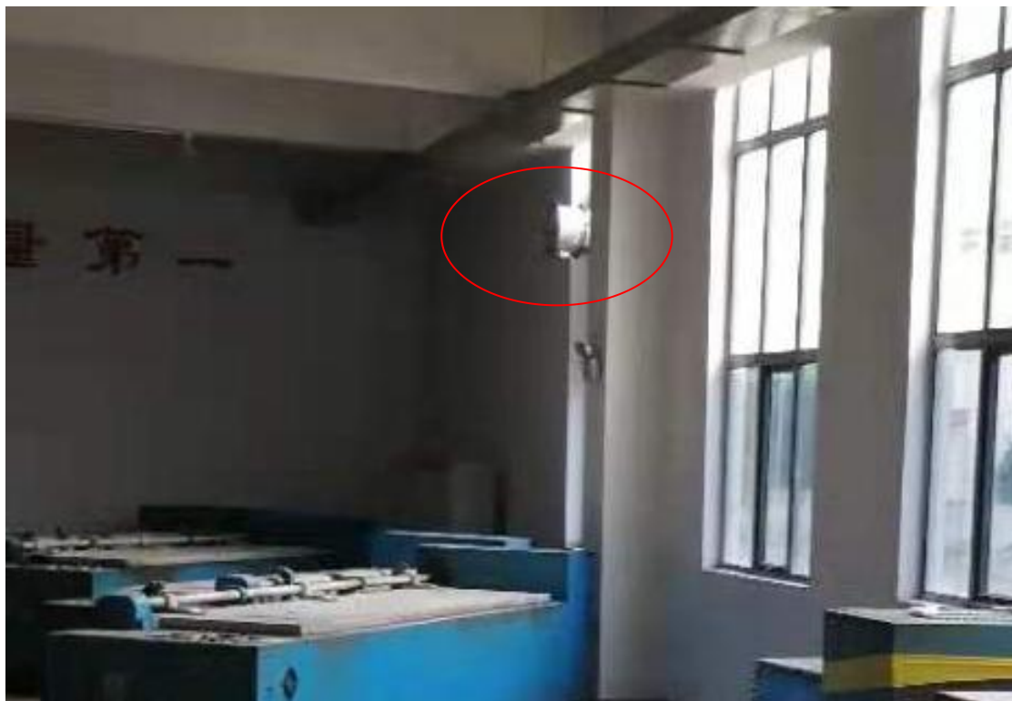
图 4.1-5 烘干固化、调漆刷漆和清洗等工序集气系统
